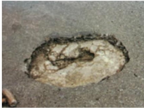
コンクリート床版上のはく離の例 土木学会鋼構造委員会, 道路橋床版の維持修繕マニュアル2016
