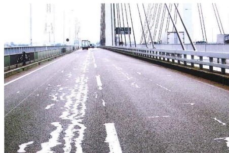
鋼床版上のひび割れの例 松野, アスファルト舗装の破損とパフォーマンス, p.91, 2011
